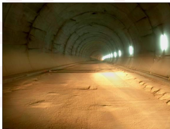
Figura 10.3.2 Aspecto del hinchamiento de una marga en la solera del túnel de Lilla (Tarragona)
