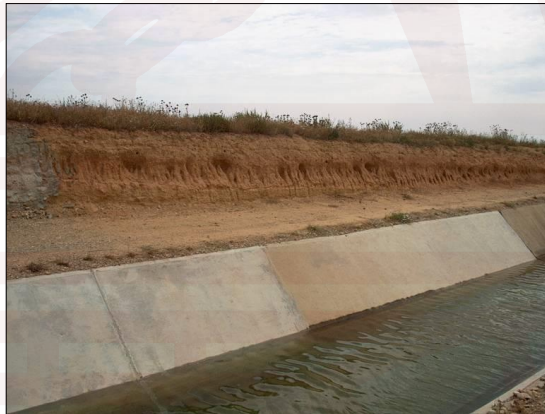
Figura 10.3.1 Aspecto de un colapso en limos naturales de baja densidad en el canal Algerri-Balaguer (Lleida)
